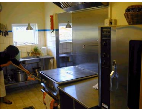
Elforbruget i fælleshusenes køkkener er stort på grund af de mange aktiviteter og industrielle forhold.
